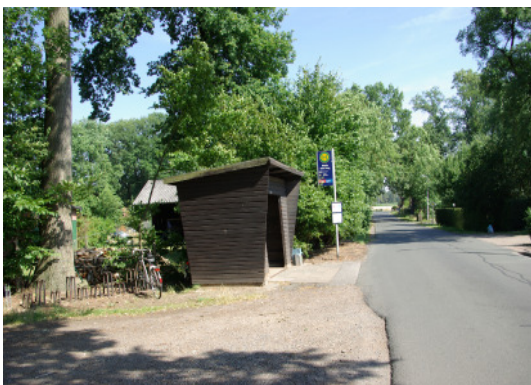
Abb. 18: Erneuerungsbedürftiges Buswartehaus in Nöpke
